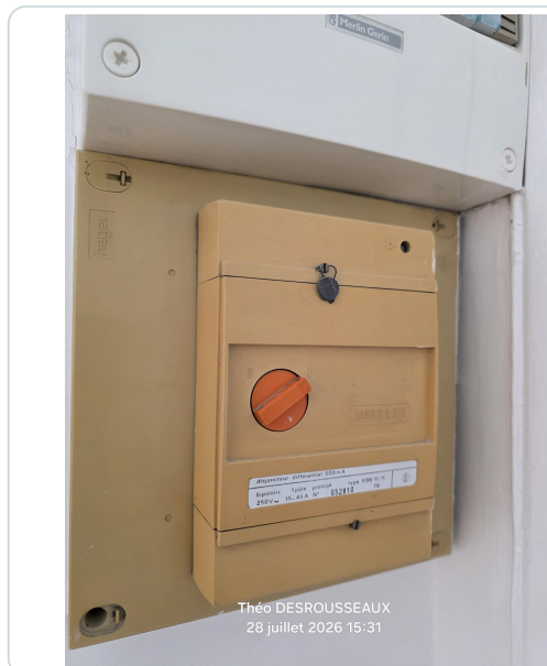
Disjoncteur de branchement 500 mA (photo A14)
