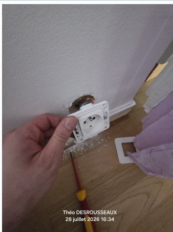
Mécanisme et bornes accessibles (A51)
