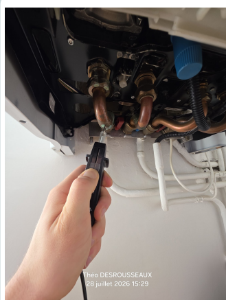
Canalisation cuivre (A06)
