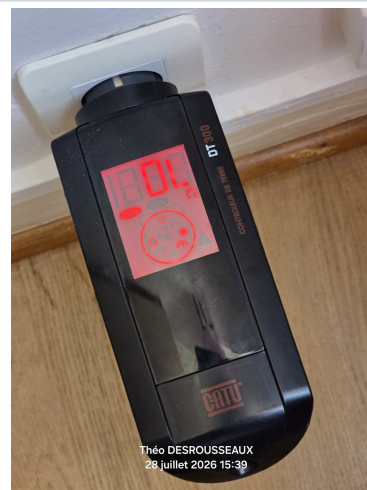
DT300 - anomalie de terre (A21)
