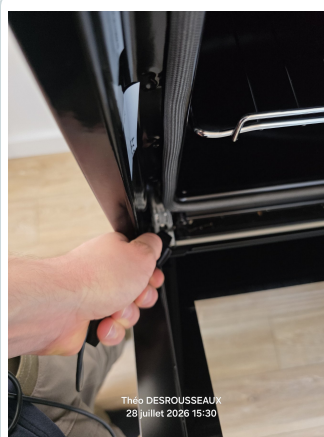
Châssis du four (A12)
