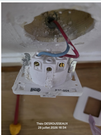
Prise ouverte - contrôle visuel (A49)
